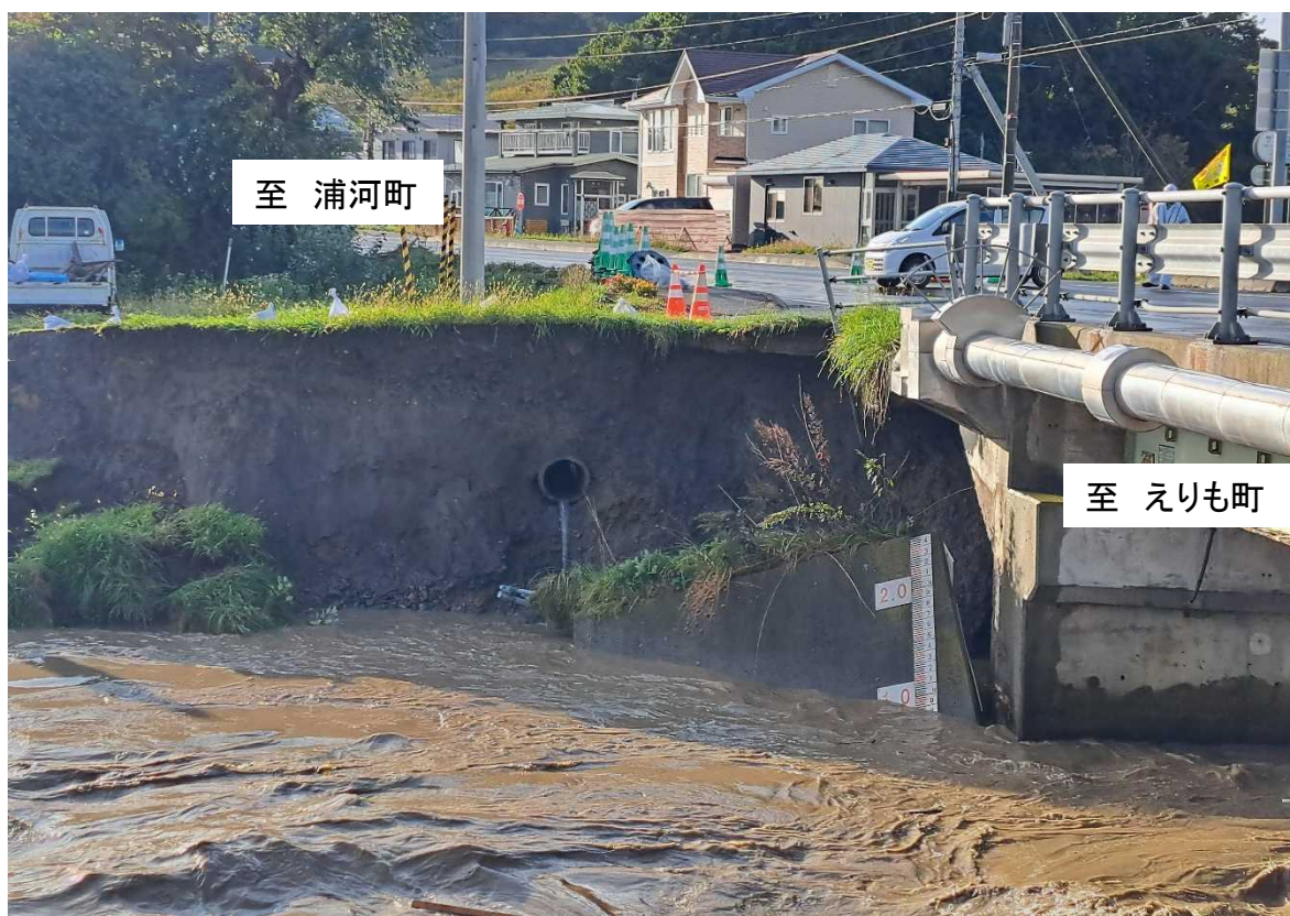
かんべつばし 国道336号 寒別橋 橋台の洗掘状況 (10月5日16:00時点)
