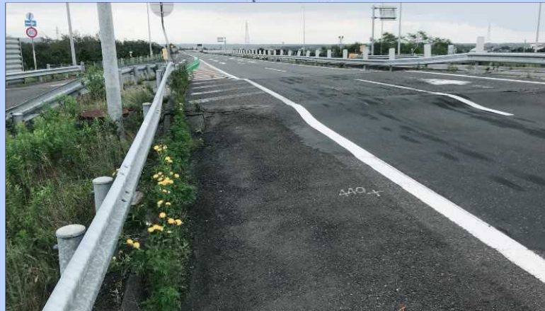
【写真②】鷓川IC合流部本線の段差
