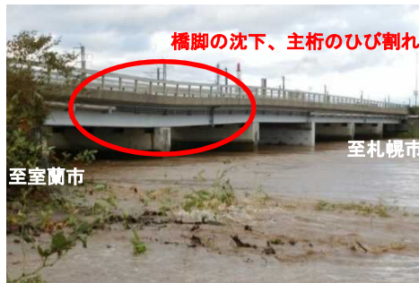
平成29年9月18日被災 ＜被災状況＞
