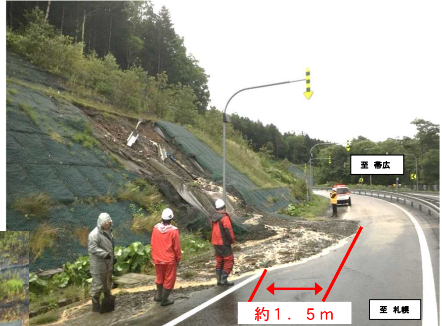
切土法面崩壊状況①
