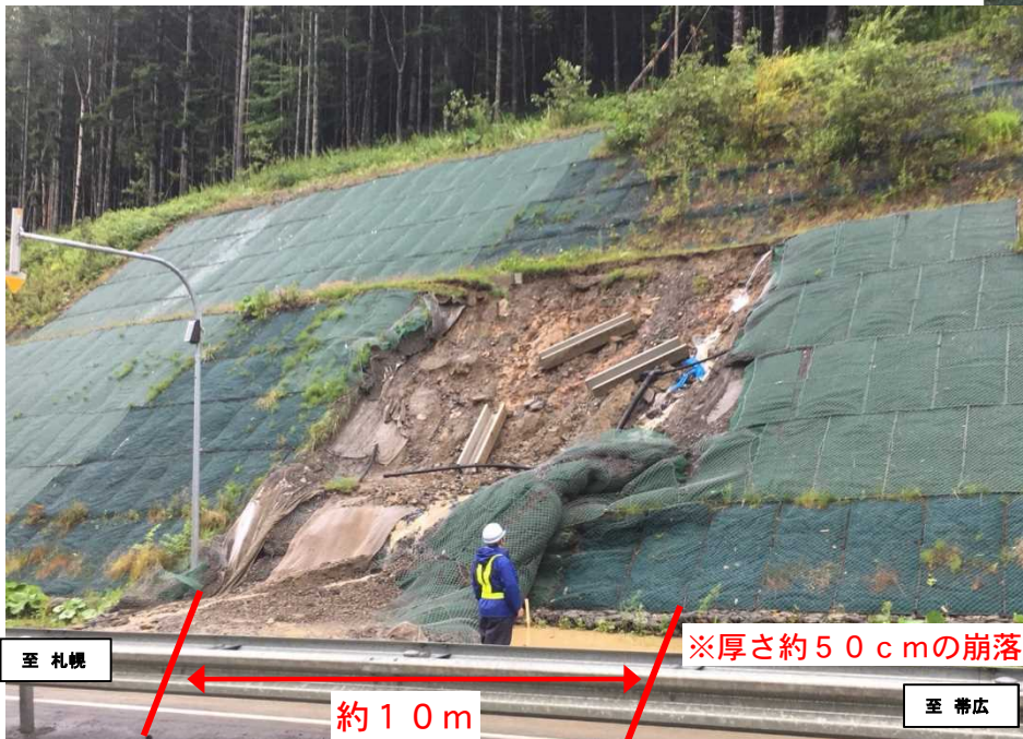
切土法面崩壊状況②
