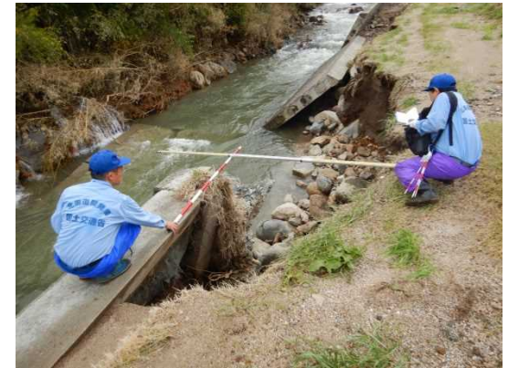
△被災状況調査
