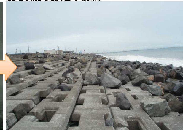
越波後の状況(平成28年9月9日)
