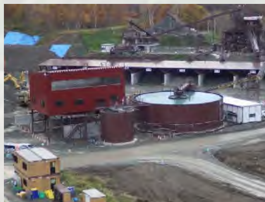
骨材プラントの濁水処理設備
