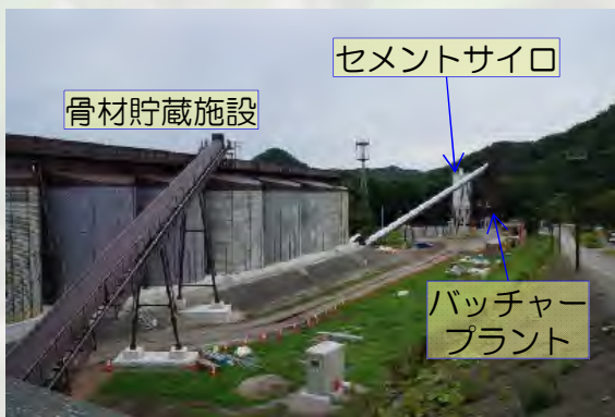
コンクリート製造設備
