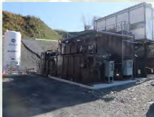
ダムサイトの濁水処理設備
