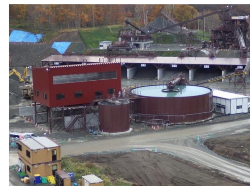
骨材プラントの濁水処理設備
