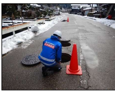
【被災施設の調査】
