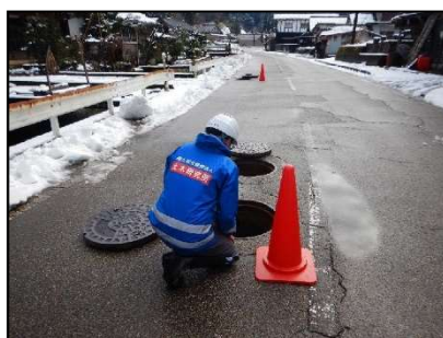
【被災施設の調査】
