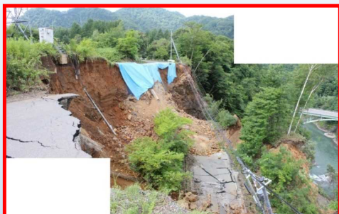
日高町 町道崩落 H28. 7. 30
