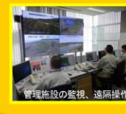
管理施設の監視、遠隔操作
