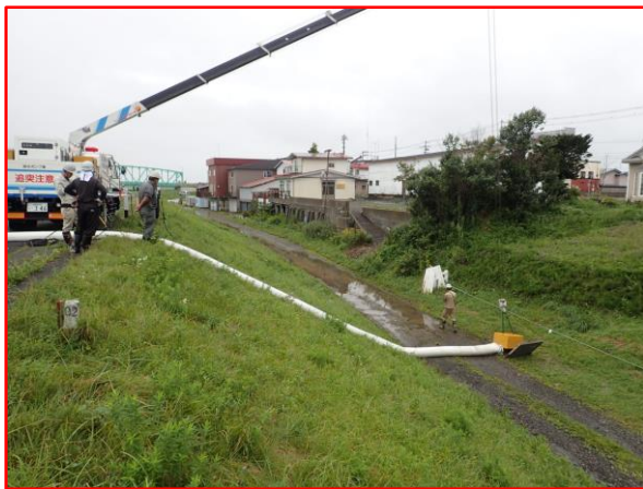
写真 2-1 栄町樋門 ポンプ車排水状況 (平成28年(2016年)8月洪水)
