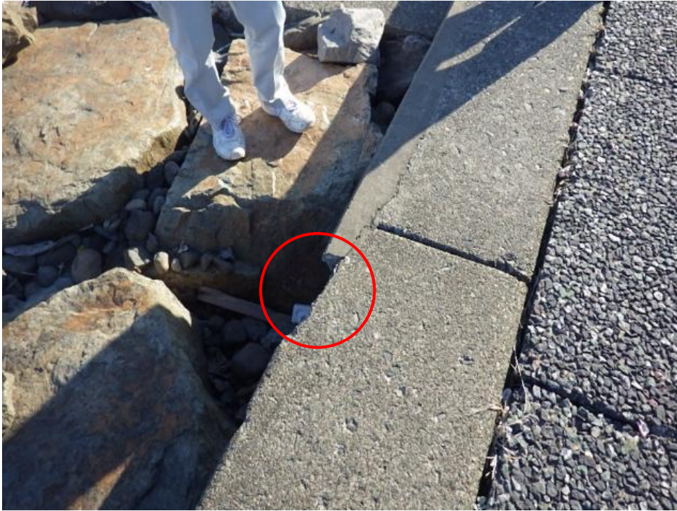
写真⑪ 天端端部のひび割れ(不安定部分の除去) @胆振海岸(白老工区北吉原地区)
