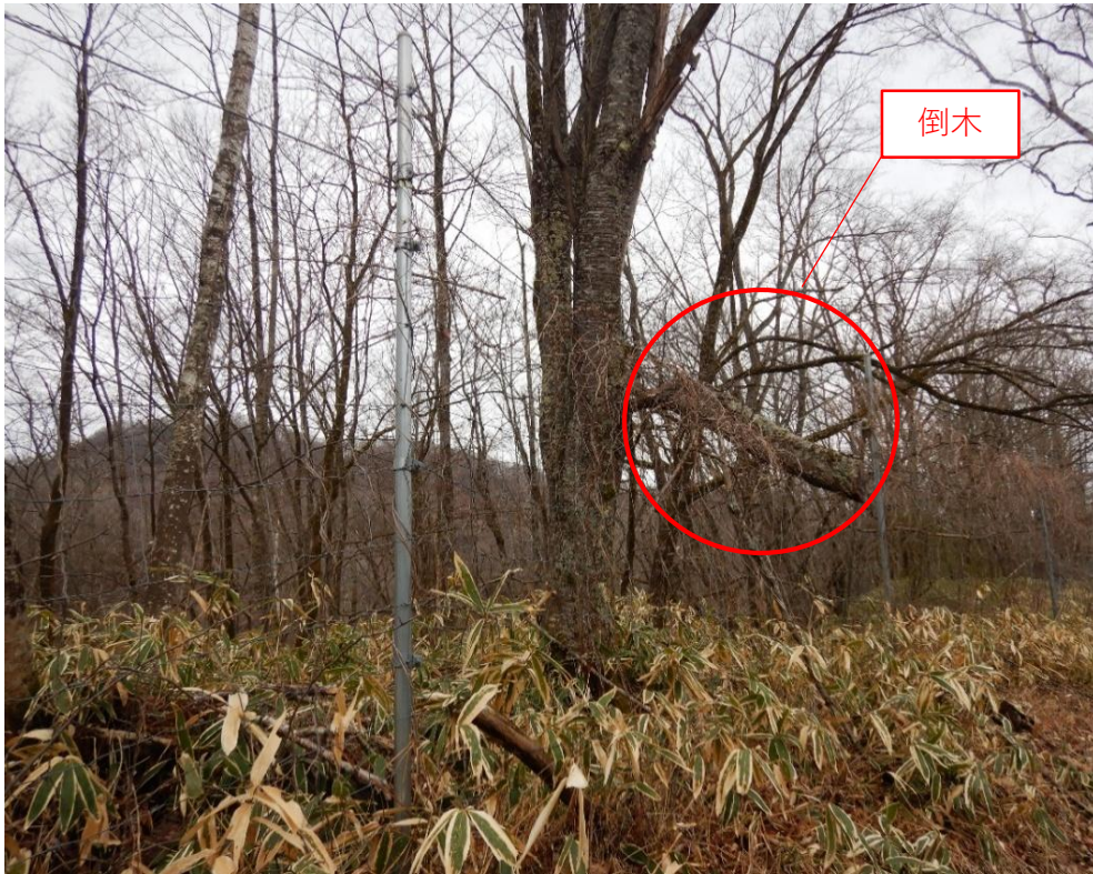
写真⑤-1 ノカプライウォロ標本園(駐車場周辺)の倒木 @平取ダム
