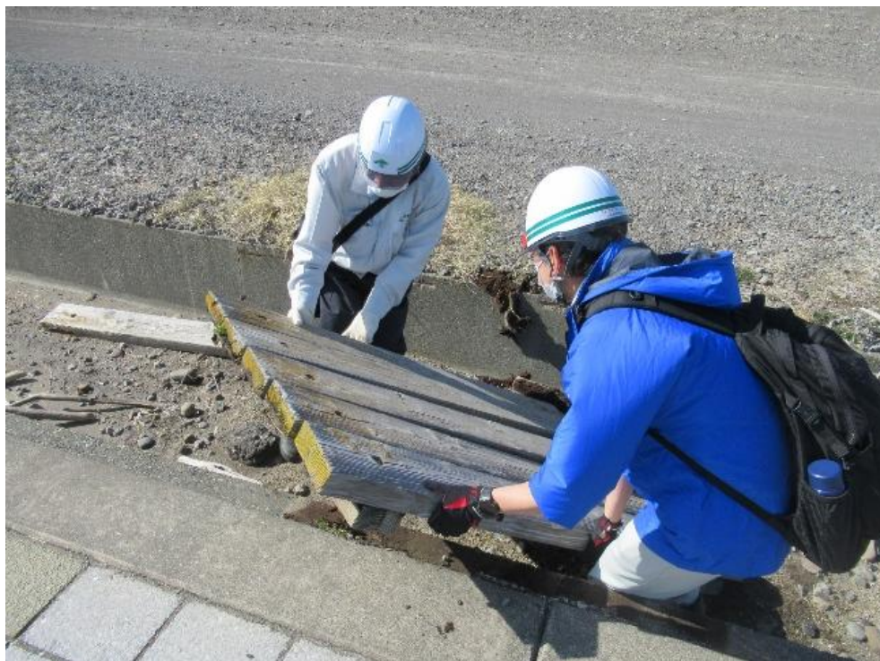
写真⑦ 歩板の劣化(撤去) @胆振海岸(苫小牧工区小糸井地区)
