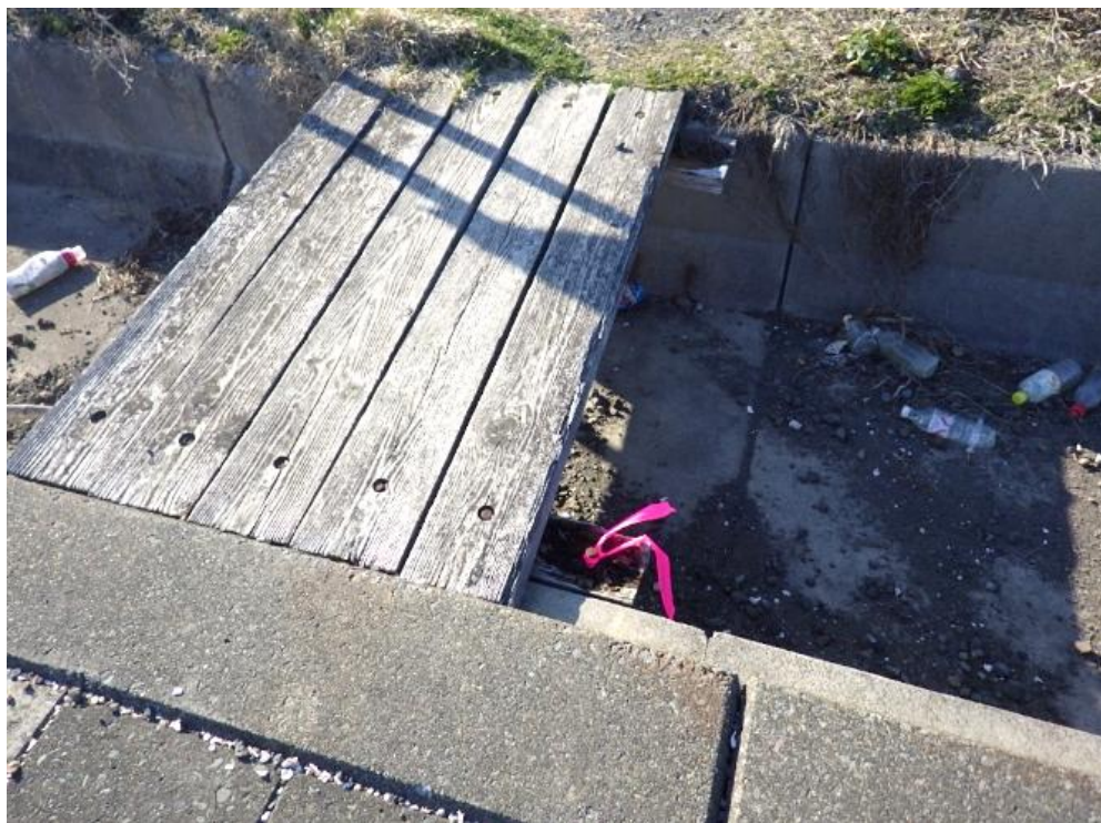
写真⑩ 突起物の露出(注意喚起マーキングテープ) @胆振海岸(白老工区北吉原地区)
