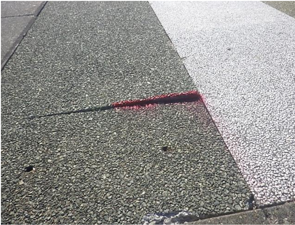
写真⑨ 護岸天端の段差(注意喚起マーキング) @胆振海岸(白老工区社台地区)
