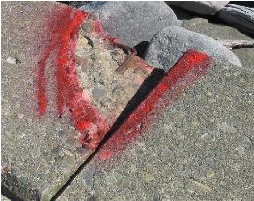
写真⑥ 護岸天端の段差・欠損(注意喚起マーキング) @胆振海岸 (苫小牧工区有明地区)
