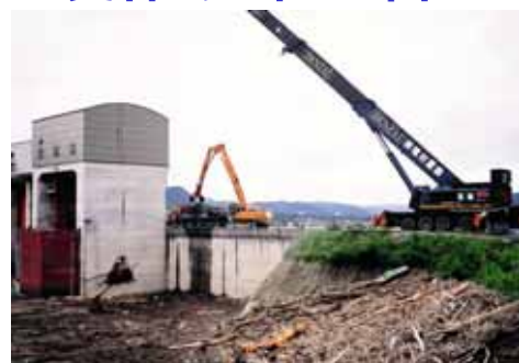
流木撤去状況
