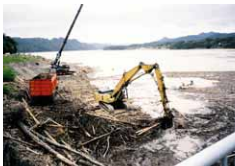
流木撤去状況
