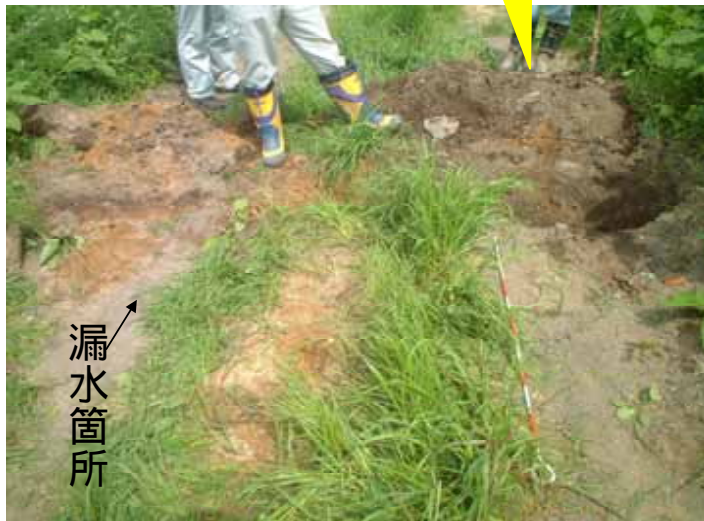
富川地先(河口から約6km)の漏水箇所
