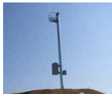
監視用カメラ
