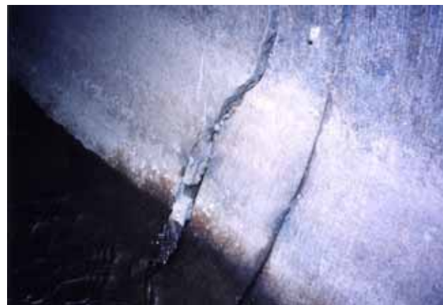
樋門破損状況
