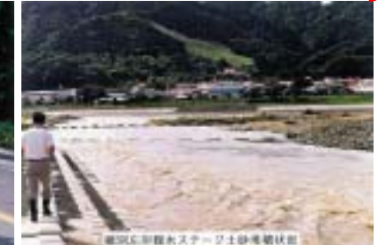
穂別左岸親水ステージ土砂堆積状況
