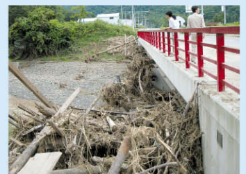
流木が詰まった橋梁
