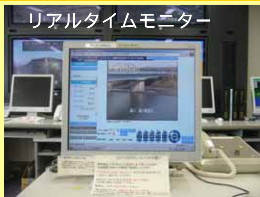
管理施設の監視、遠隔操作
