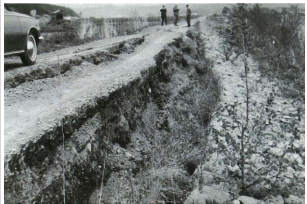
豊城築堤 堤防のすべり破壊
