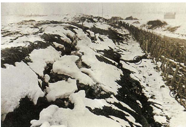
豊城築堤の亀裂
