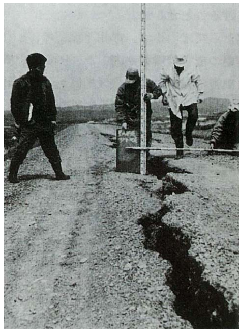
豊城地区堤防天端の亀裂
