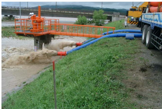
ポンプ排水状況(穂別 1 号樋門、平成 15 年 8 月洪水)
