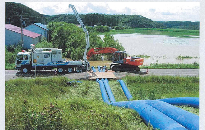
とよこらちょう あんこつ 豊頃町安骨樋門での排水作業
