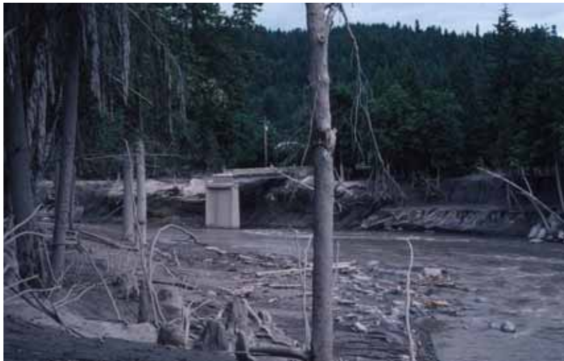
泥流で橋が流された跡（アメリカ セントヘレンズ火山）
