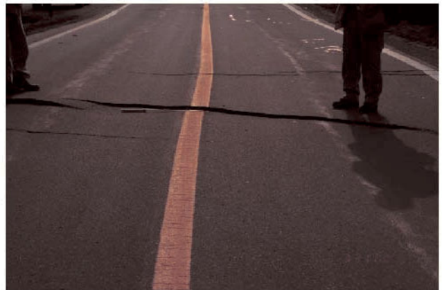
湖岸道路で見られた前兆の地割れ
