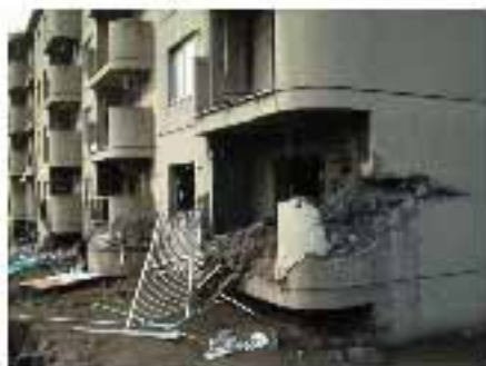
被害を受けたアパート
