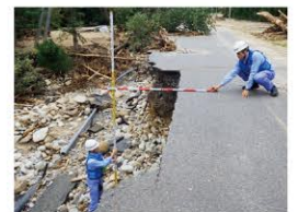
町道の被災状況調査(清水町)
