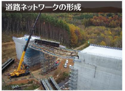
北海道横断自動車道網走線の橋梁上部架設工事 (陸別一陸別小利別間)
