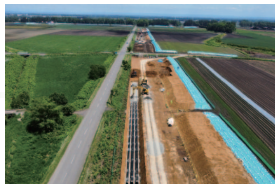
用水の安定供給に向けて管の布設作業(芽室川西地区 帯広市)
