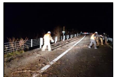
国道236号（帯広市昭和町）折れた高木の処理状況
