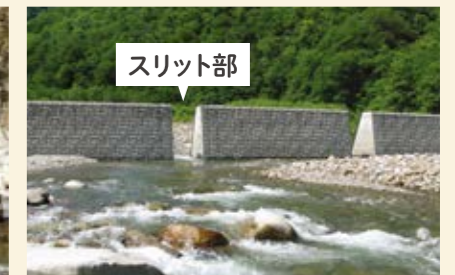
スリット型の堰堤
