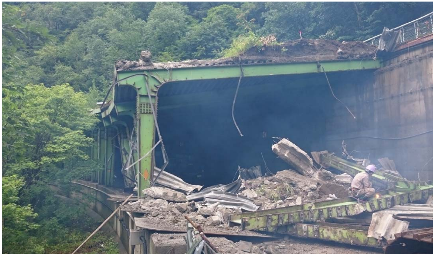
損傷した道路附属物撤去状況（20日 午後3時 時点）
