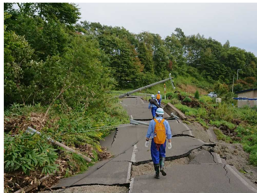
9月8日 現地調査状況(道路班) 厚真町
