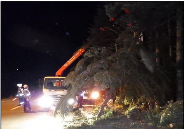
国道236号（帯広市昭和町） 折れた高木の処理状況
