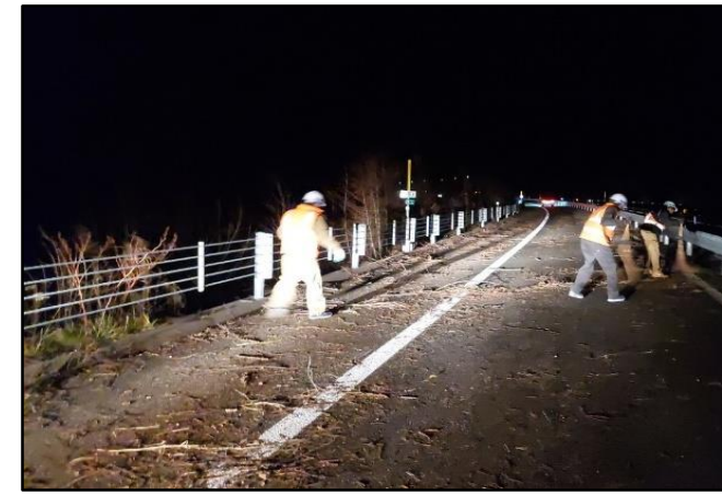
帯広・広尾自動車道（中札内IC～更別IC） 飛来した枝葉の処理状況
