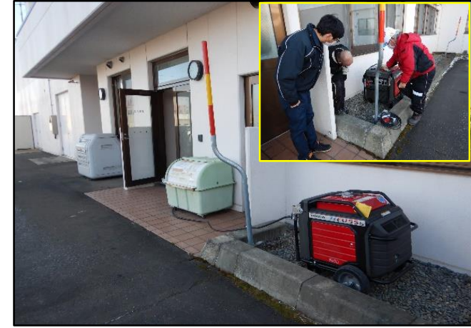
福祉の里総合センター 発動発電機の機器説明・設置状況
