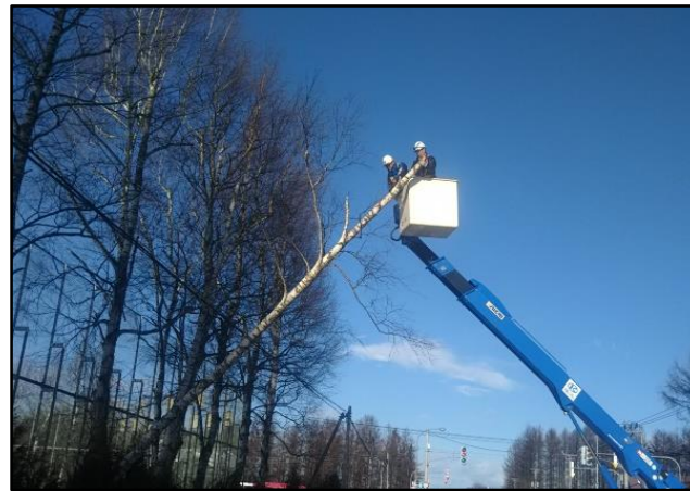
国道236号（更別村字更別基線） 倒れてきている高木の処理状況
