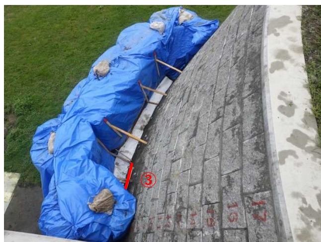
染み出し対策箇所③の状況 (9/12撮影)
