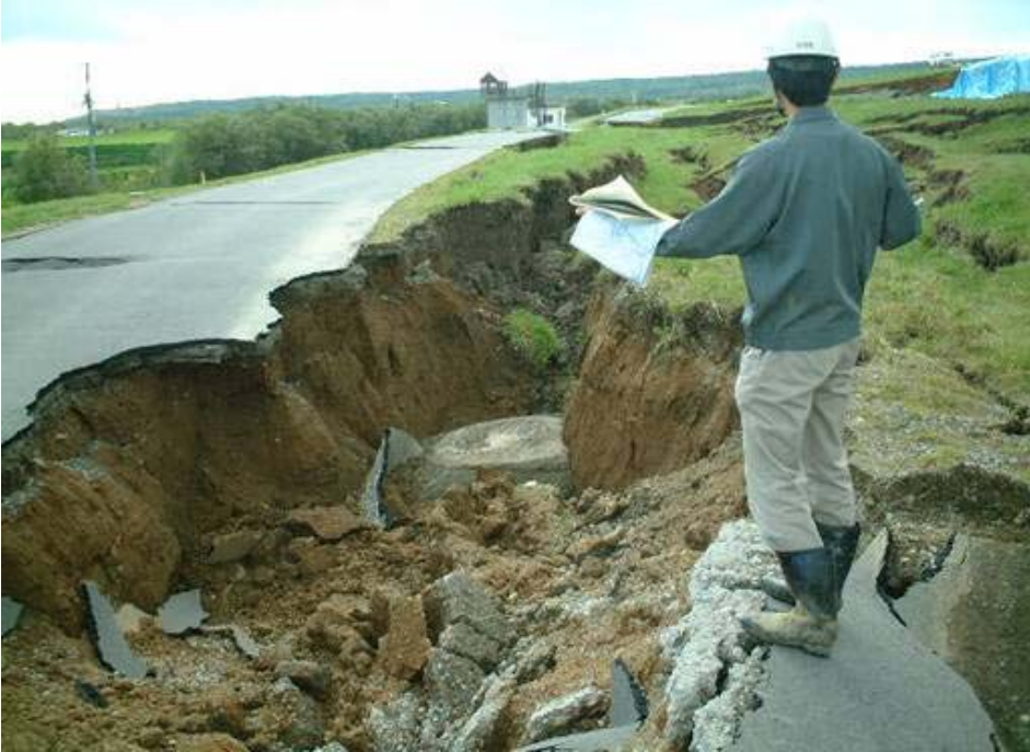
1. 十勝川右岸KP2.967～KP3.927 (十勝川右岸大津樋門下流地先緊急災害復旧工事) (着手前) (着手後)
