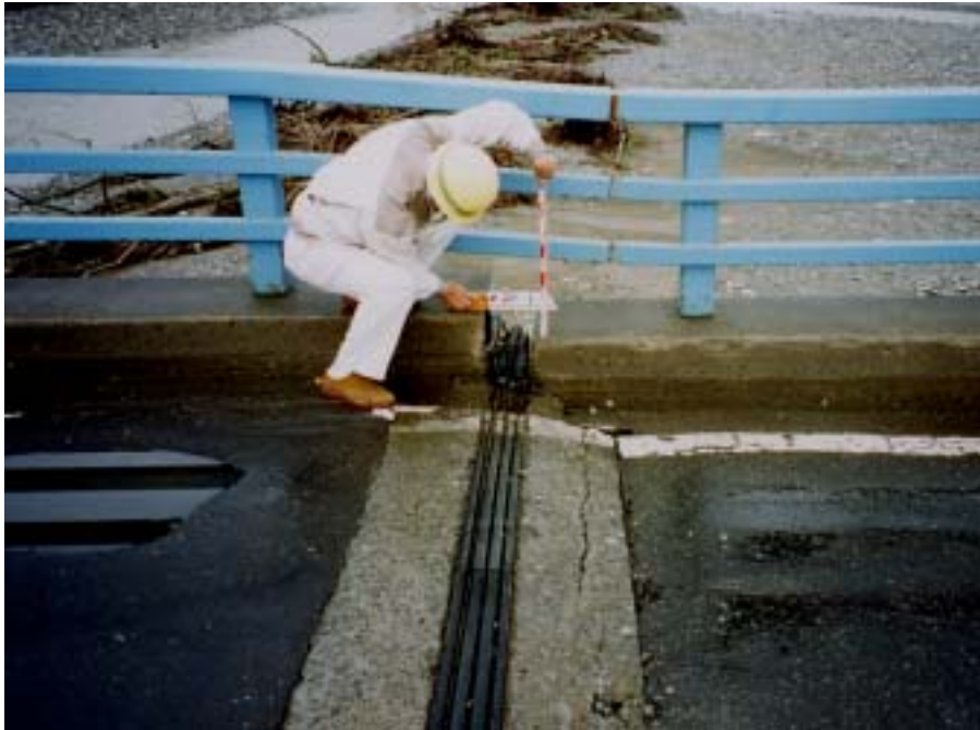
R 3 3 6 歴舟橋(段差)
