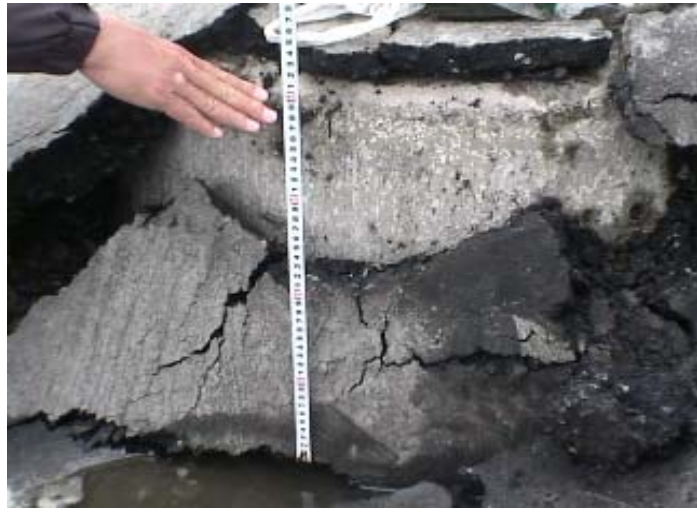
マンホール周辺の被災状況
