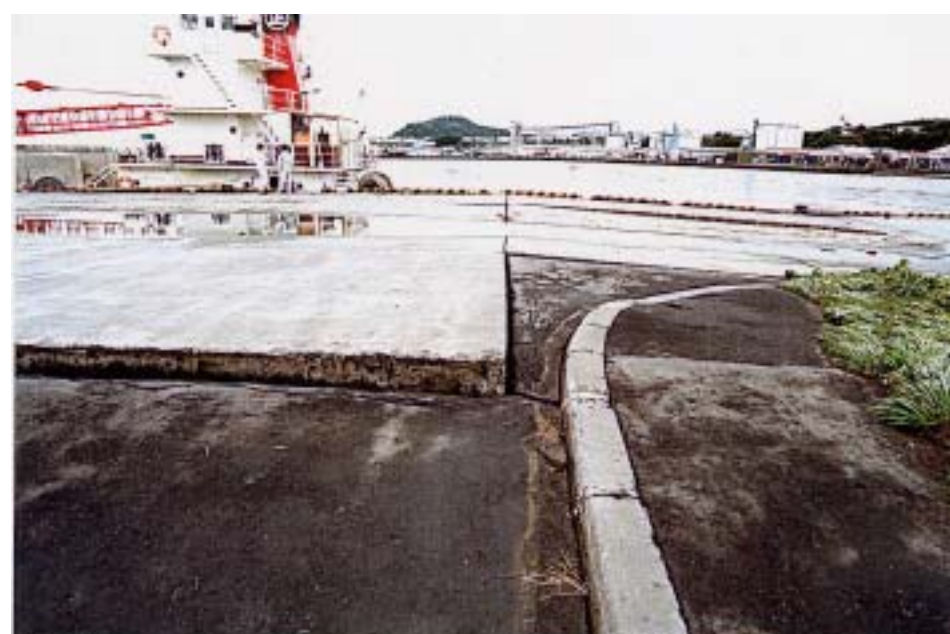
第3ふ頭：道路沈下
