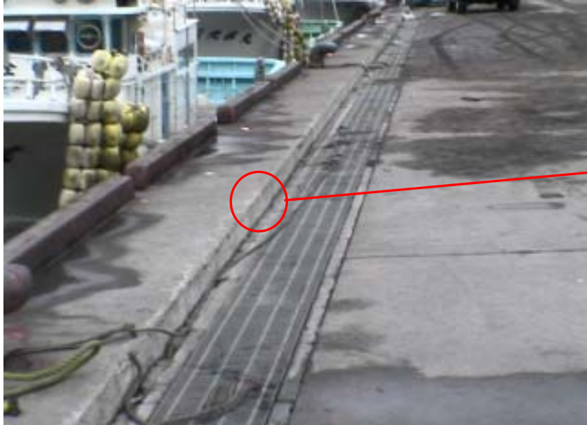
- 3.5m岸壁:エプロン沈下
