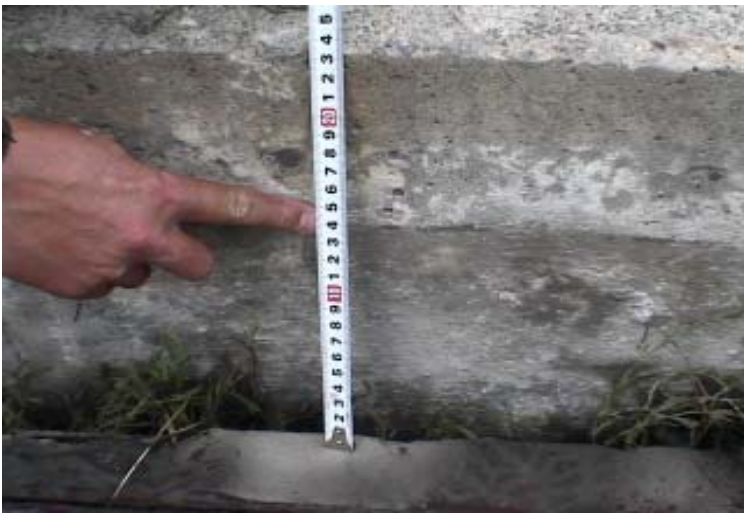
エプロン沈下状況
