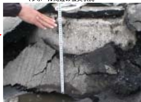
マンホール周辺の被災状況
