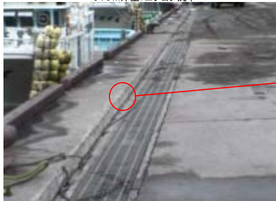
- 3.5m岸壁:エプロン沈下
