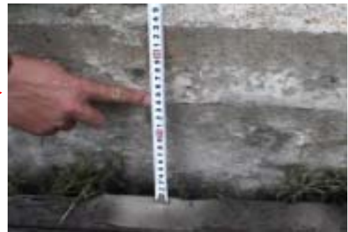
エプロン沈下状況
