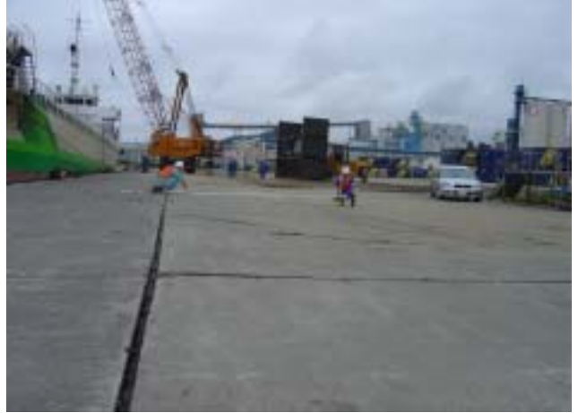
第2ふ頭：エプロン沈下
