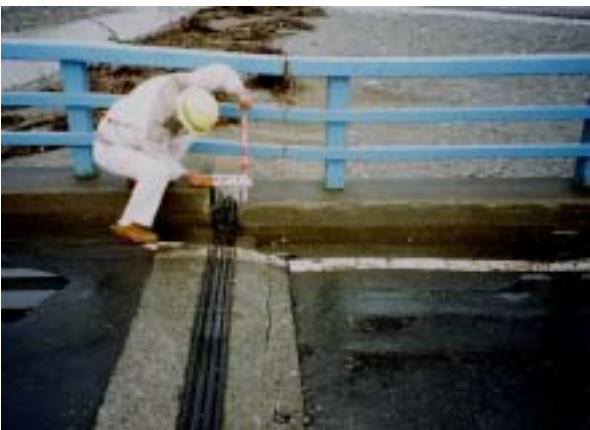
R 3 3 6 歴舟橋(段差)
