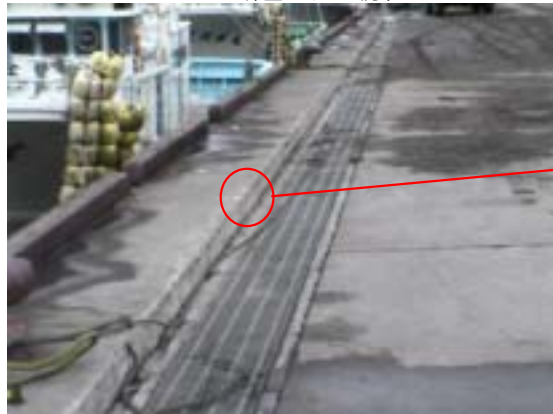
- 3.5m岸壁:エプロン沈下
