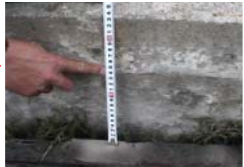
エプロン沈下状況
