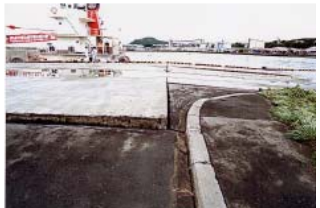
第3ふ頭：道路沈下
