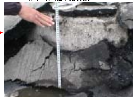
マンホール周辺の被災状況
