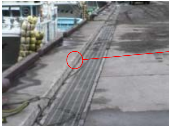
- 3.5m岸壁:エプロン沈下
