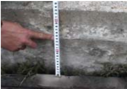
エプロン沈下状況
