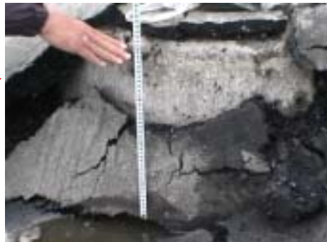
マンホール周辺の被災状況
