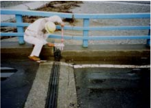
R 3 3 6 歴舟橋(段差)
