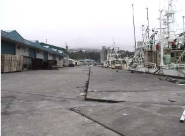
漁港区：エプロン沈下
