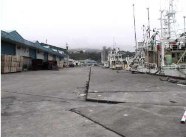
漁港区：エプロン沈下
