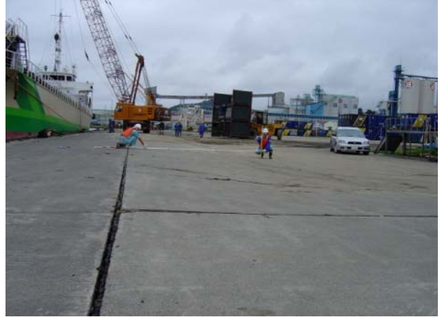
第2ふ頭：エプロン沈下
