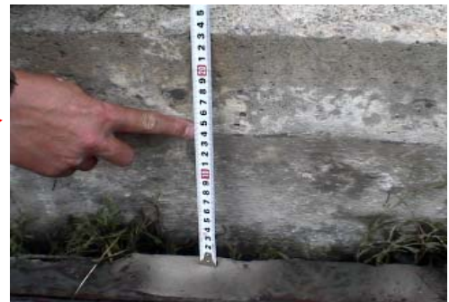
エプロン沈下状況
