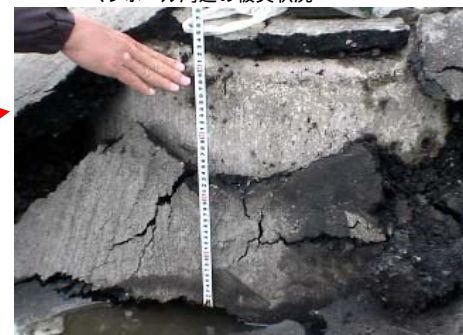
マンホール周辺の被災状況
