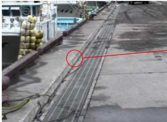
- 3.5m岸壁: エプロン沈下
