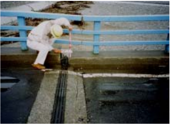
R 3 3 6 歴舟橋(段差)
