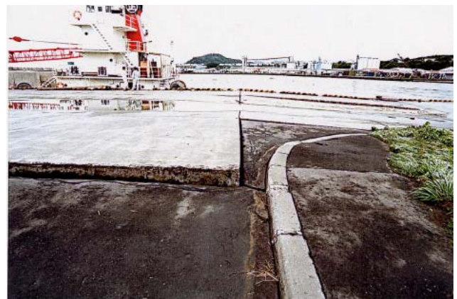
第3ふ頭：道路沈下
