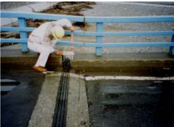
R 3 3 6 歴舟橋(段差)
