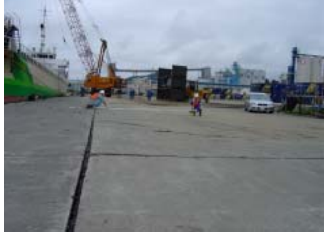
第2ふ頭：エプロン沈下
