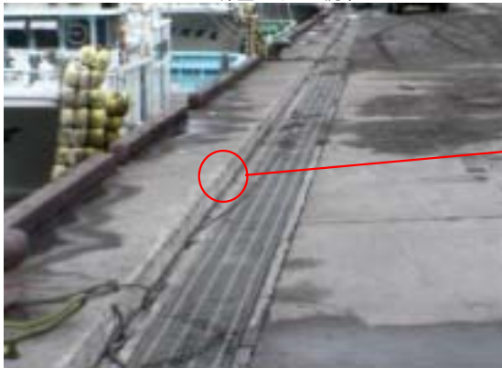
- 3.5m岸壁: エプロン沈下
