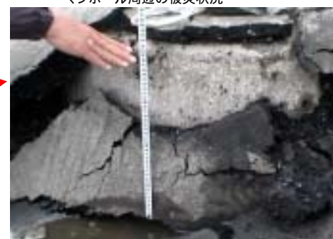
マンホール周辺の被災状況
