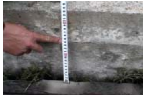
エプロン沈下状況
