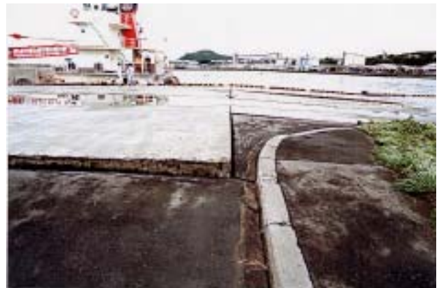
第3ふ頭：道路沈下
