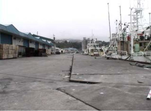
漁港区：エプロン沈下
