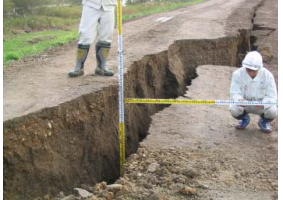
32 浦幌十勝川 浦幌太築堤 左岸 KP4.7付近 (堤防天端亀裂)
