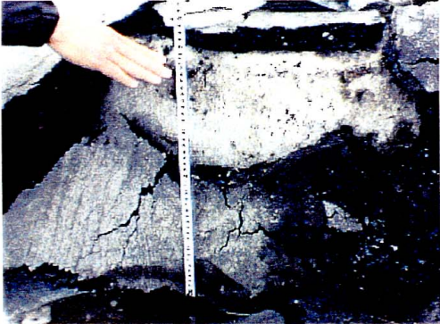
マンホール周辺の被災状況
