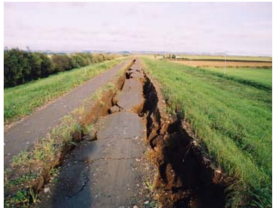
11 十勝川 育素多築堤 左岸 KP24.0付近 (堤防天端亀裂)
