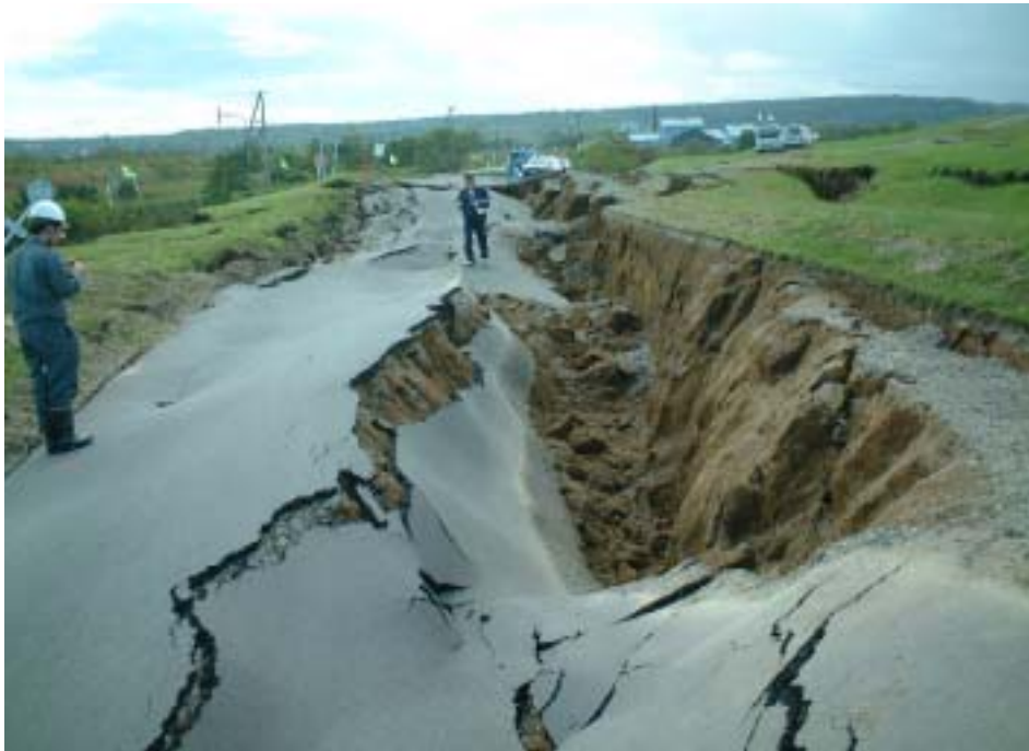
29 十勝川 大津築堤 右岸 KP3.5付近 (管理用道路法すべり)
