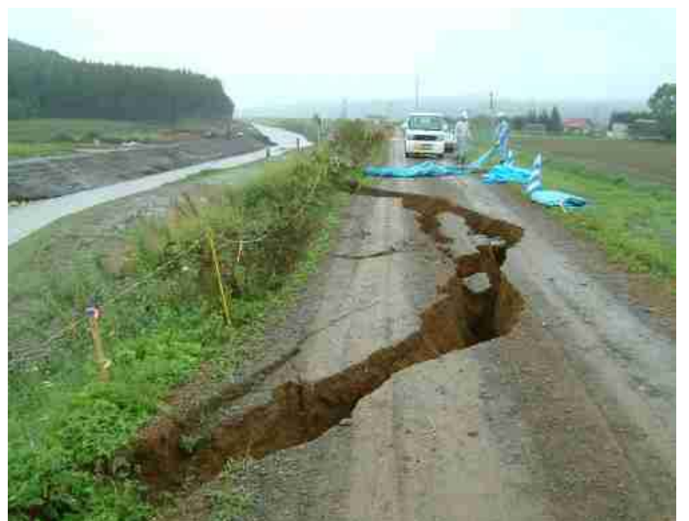
14 牛首別川 牛首別築堤 左岸 KP2.6付近 (法すべり)
