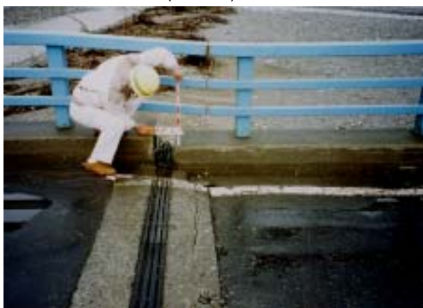
R 3 3 6 歴舟橋(段差)
