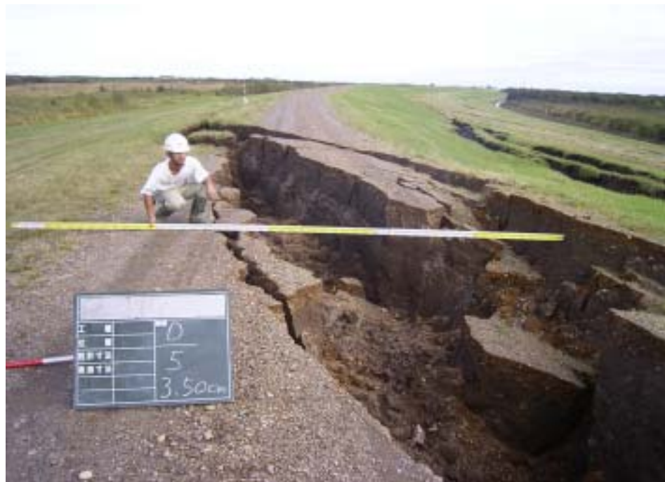
29 十勝川 右岸 大津築堤 KP5.0付近 (法すべり)
