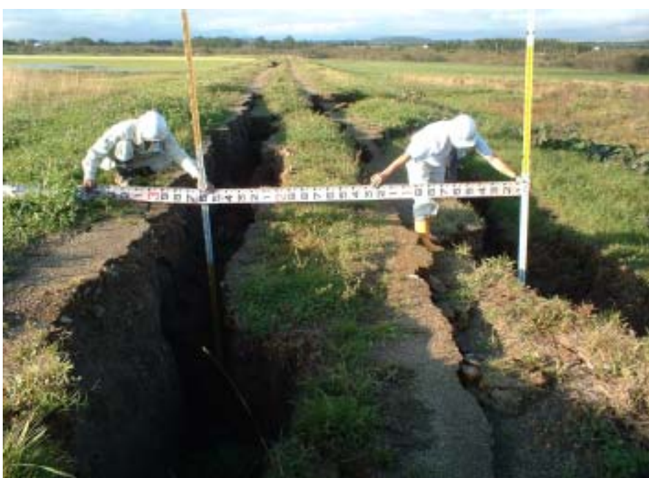
3 - 1 礼文内川 左岸 KP1.6付近 (堤防天端亀裂)
