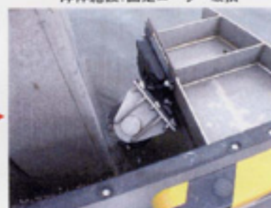
浮体施設：固定ローラー破損
