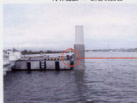
④-4. 5m岸壁（漁業取締船係留施設） 浮体施設：鋼管杭変位
