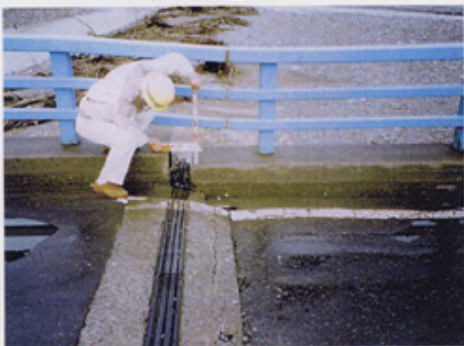
R336歴舟橋(段差)
