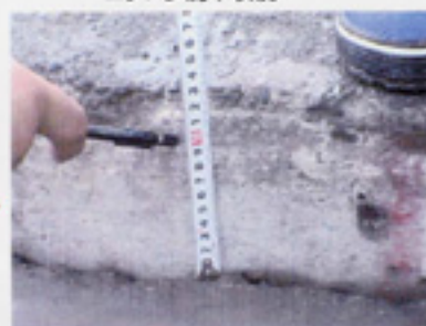
エプロン沈下状況
