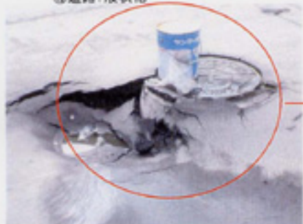
⑪道路：液状化
