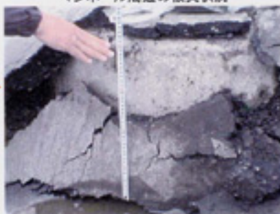
マンホール周辺の被災状況
