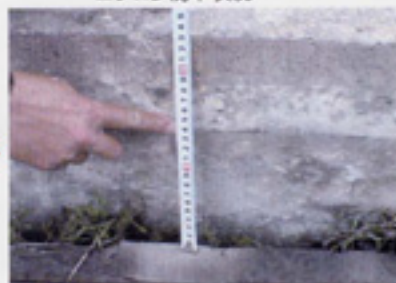
エプロン沈下状況
