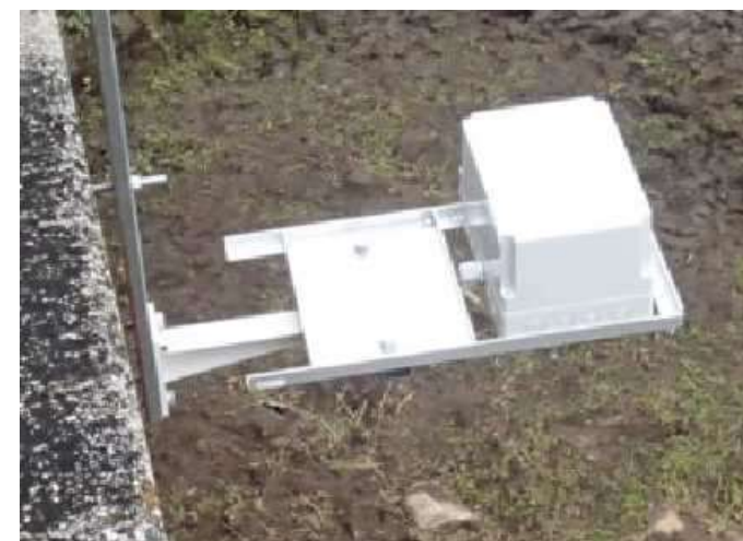
水位計設置事例
