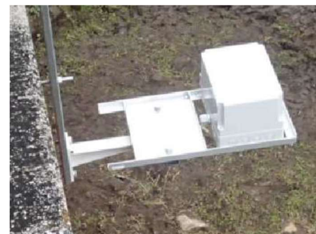
危機管理型水位計設置事例
