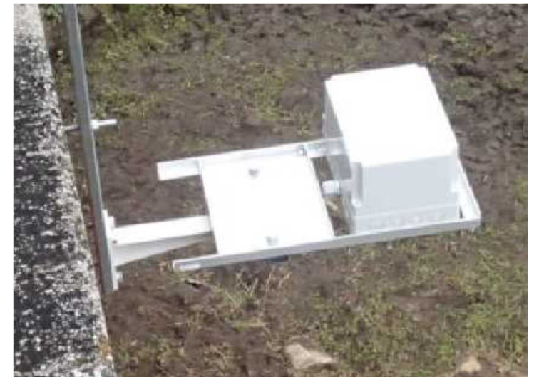
水位計設置事例
