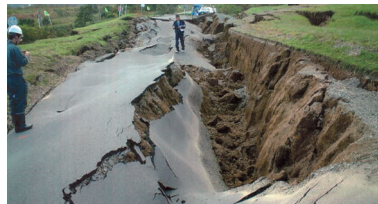
陥没した堤防（十勝川大津樋門下流地先）
