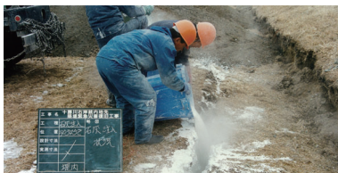
ひび割れた築堤の災害復旧（十勝川右岸統内地先）
