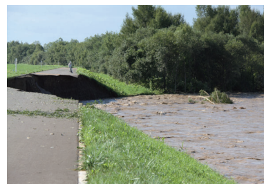
浸食した堤防（音更川）
