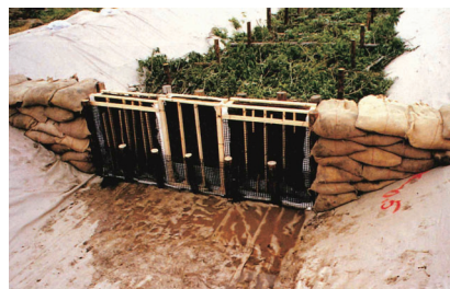
濁水を濾過する排水路
