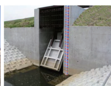
樋門の自動開閉ゲート
