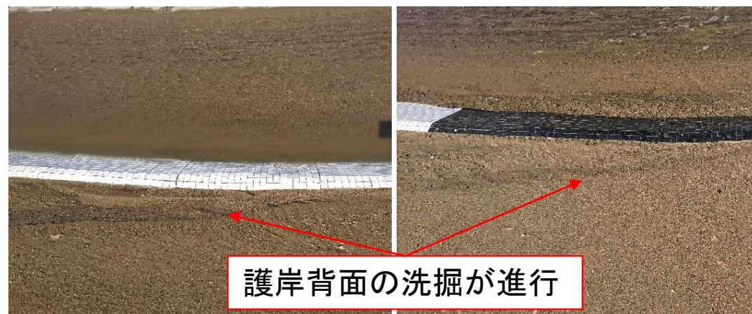
高水深下流洗掘部
