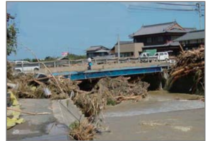
橋脚への流木閉塞被害例 (平成16年 水害レポート2004 河川局HPより)
