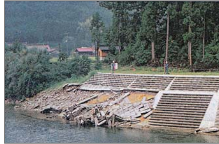
保護工の被災事例 美しい山河を守る災害復旧基本方針より
