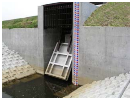
フラップゲート（自動的に開閉するゲート）
